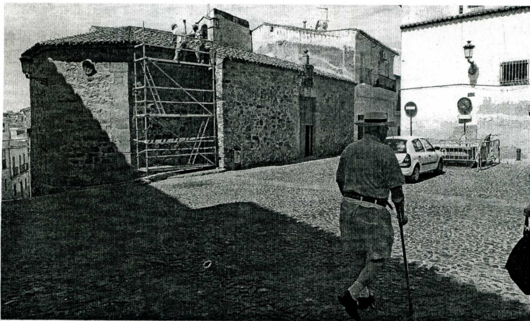
La ermita de la Soledad, junto a la calle Pizarro, arrastra goteras y humedades desde hace años. Ya han comenzado a reparar el tejado. /L. C.
